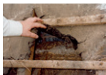
Inefficacité de l'isolation
