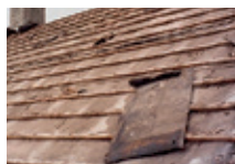
Dégradation de la structure du bâtiment
