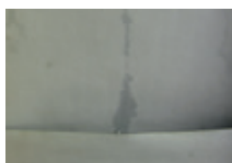
Dommages causés par des infiltrations d'eau
